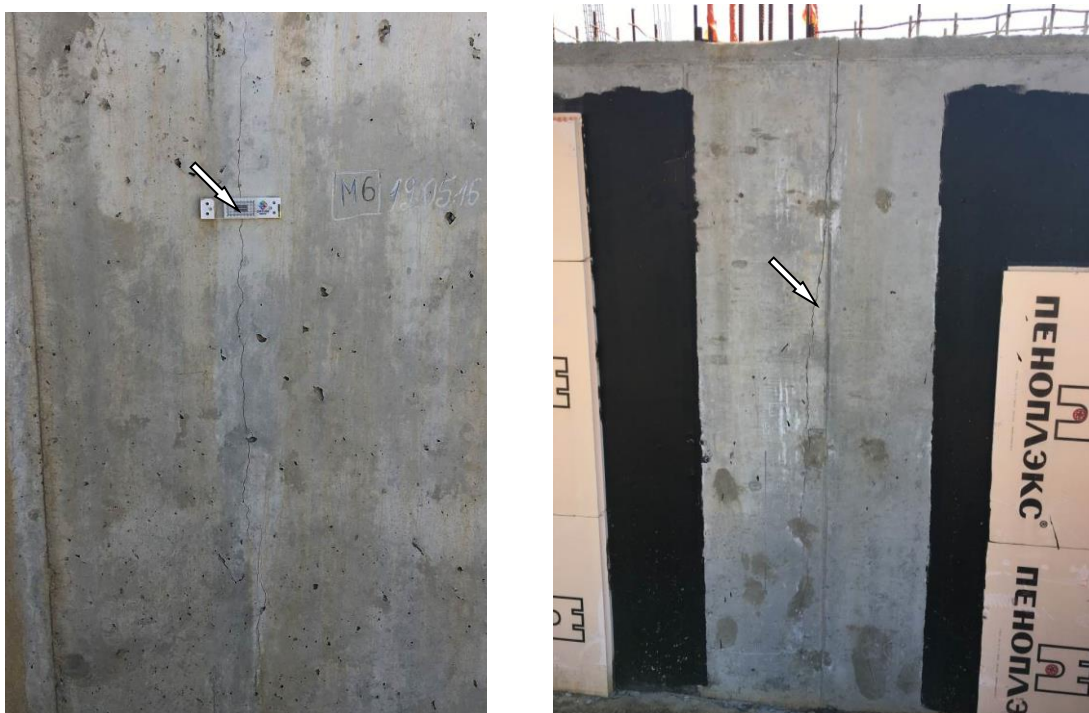
Рис. 1. Трещины шириной раскрытия от b = 0,1 мм до b = 0,3 мм на всю высоту стены цокольной части спортивного зала
